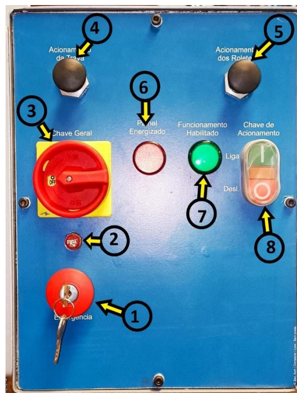
Figura 6 – Painel de Comando
