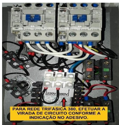
Figura 2 - Painel c/ transformador
